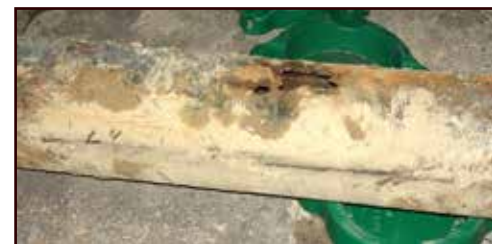
Korrosion am Wasserrohr aus globularem Grauguss.
